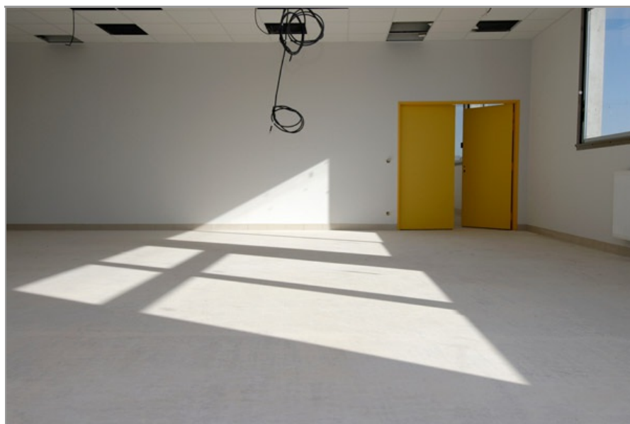
Etat de surface de la chape après ponçage
